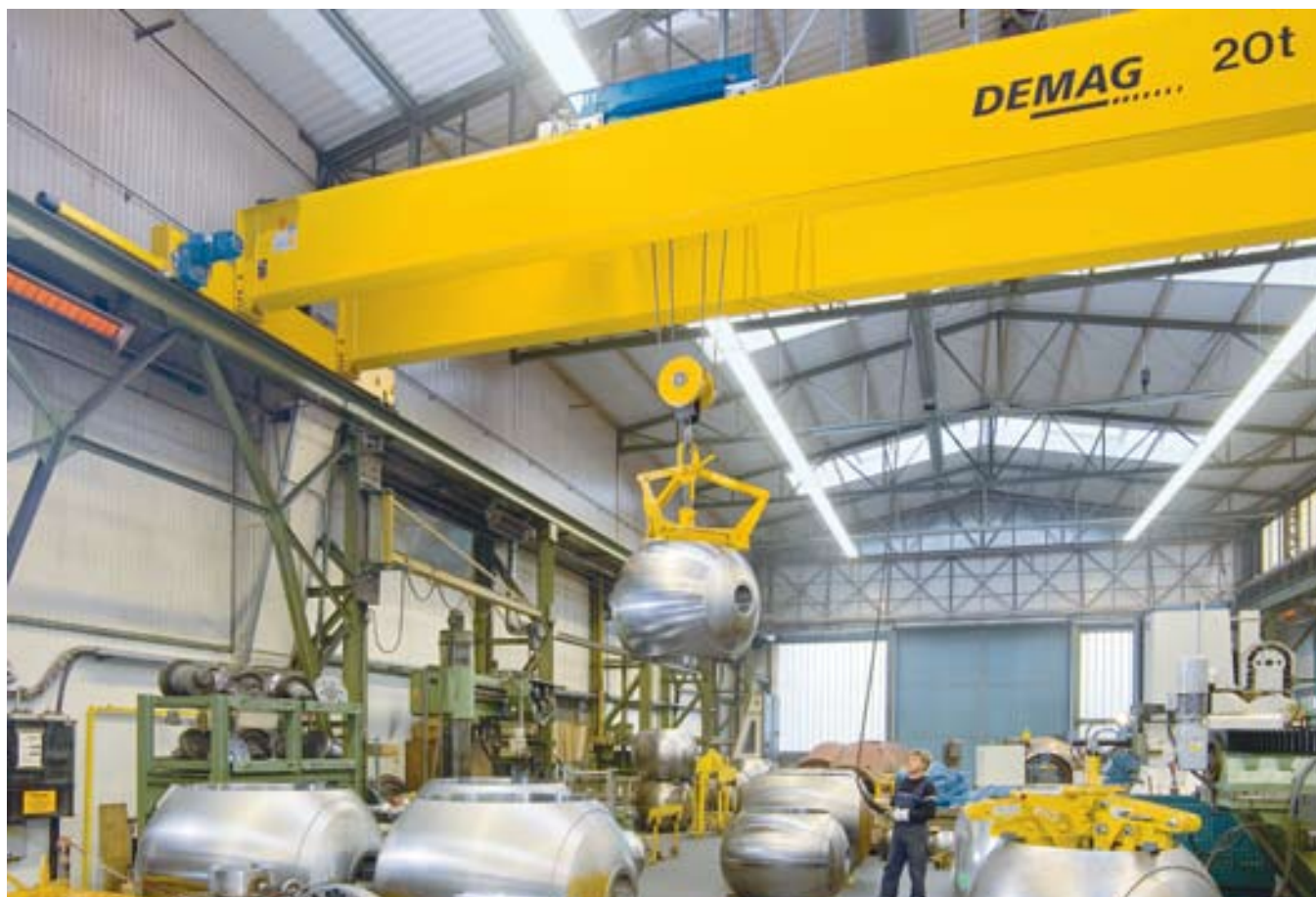
Carroponte sospeso bitrave con sollevamento lento: la valvola a sfera viene posizionata nella rettificatrice a una velocità di 0,18 m/min
