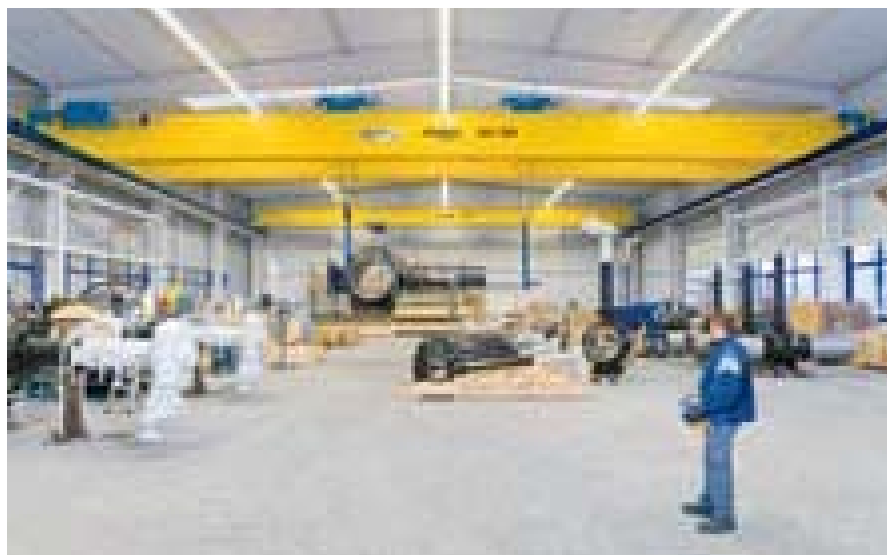
Due carriponte sospesi su un'unica via di corsa nel reparto di spedizione di RMA Pipeline Equipment.
