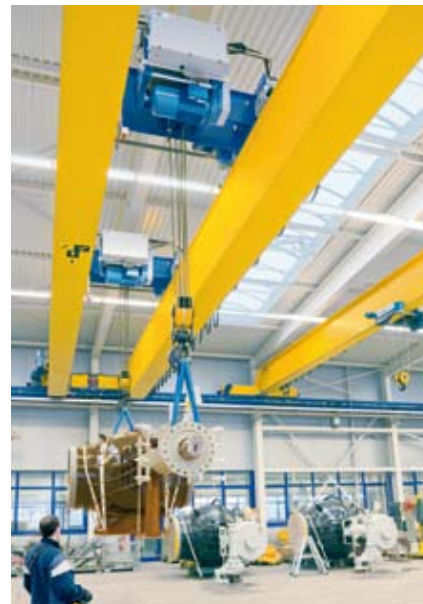
Il carroponte sospeso bitrave nel reparto di spedizione è dotato di due unità di sollevamento, ciascuna con una capacità di carico di 32 t, che possono essere azionate contemporaneamente
